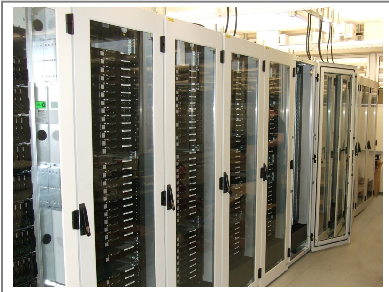
350x Intel® Xeon® Quadcore-Cluster-Nodes + 10 Steuer-Nodes, integriert in 10 wasseraekühlten Serverschränken „Cooltherm“ von Knuerr. ...
